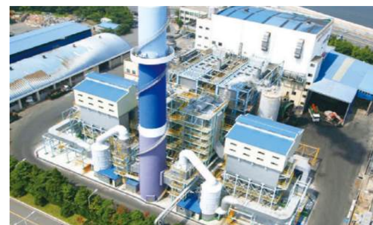
에너지네트웍 폐기물 소각 및 배가스 처리 시설
