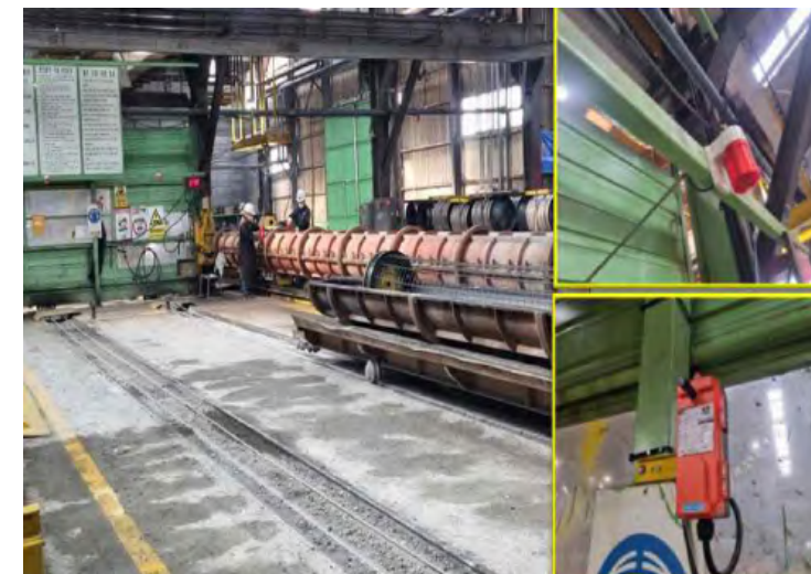
사업장 내 경보시설 설치
